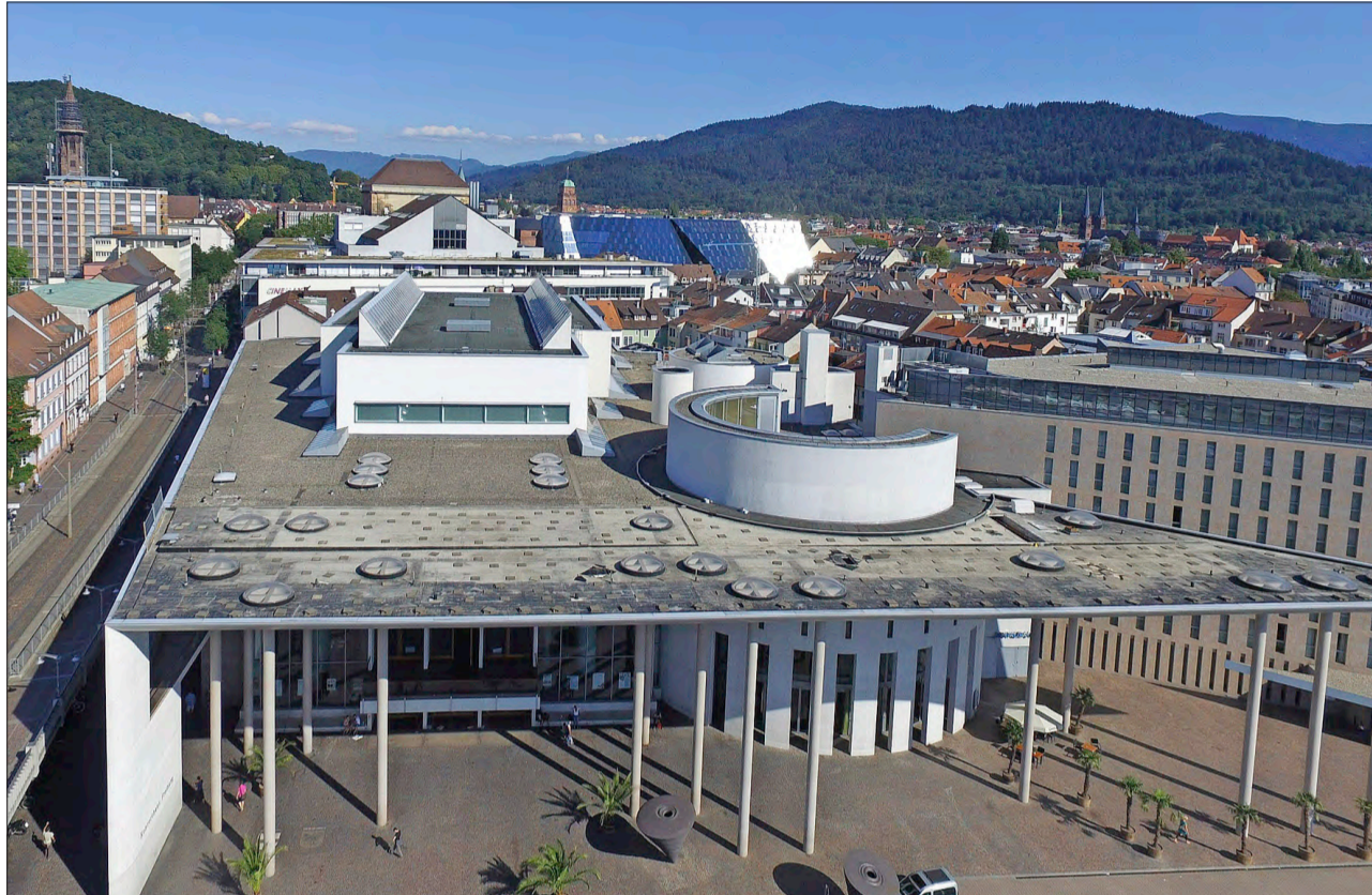
Die 5600 Flachdach-Quadratmeter des Konzerthaus müssen saniert werden.
